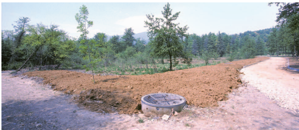
22. Zona umida di Colombaro. Primavera 2006: interramento, opere di drenaggio in profondità e realizzazione di nuove strade nel moliniето.
